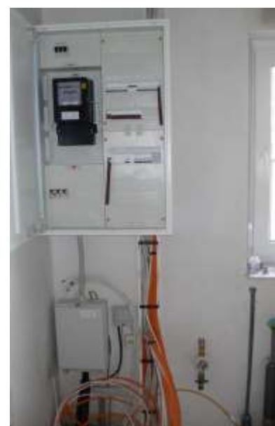
Hausanschluss/Hauptsicherung Zählerschrank/ Telekomanschluss
