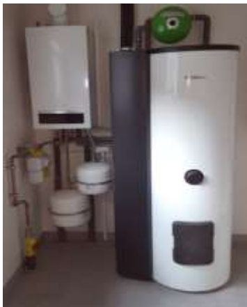
Brennwertkessel und 300L Speicher
