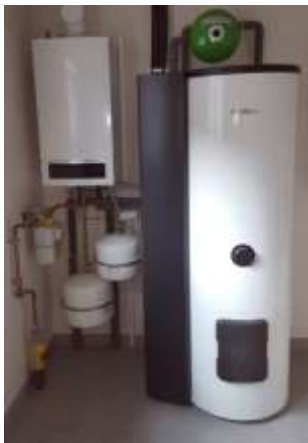
Brennwertkessel und 300L Speicher
